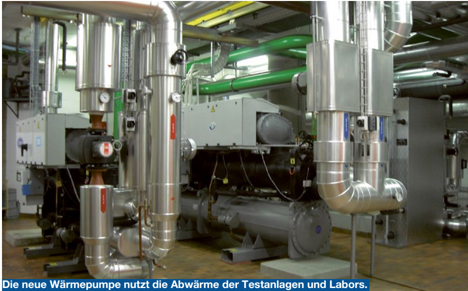
Die neue Wärmepumpe nutzt die Abwärme der Testanlagen und Labors.
