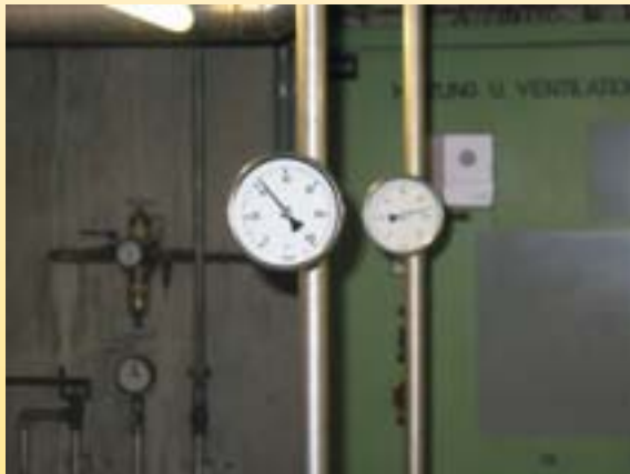
Inbetriebsetzung: Kondensatthermometer Austritt und Eintritt
