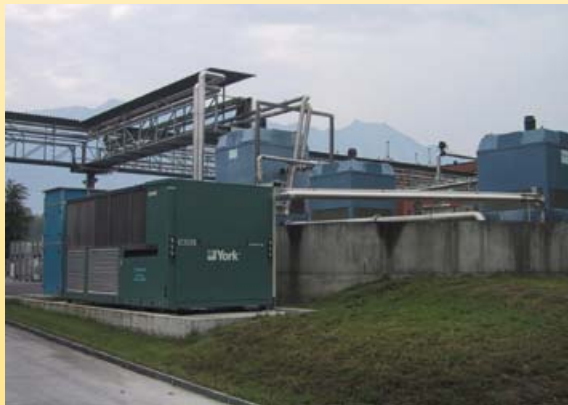
Kreislaufkühlwassersystem mit Kompressor und Wärmerückgewinnung
